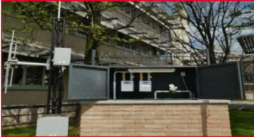
Smart Metering (Gas e Acqua)
